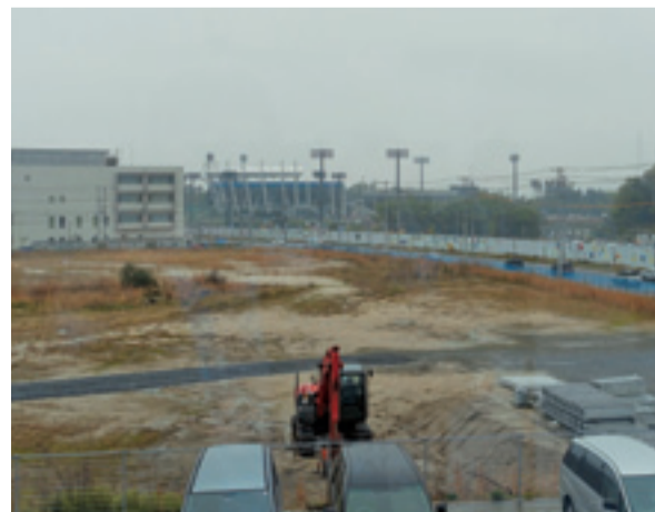
急ピッチで整備が続く愛宕山地区運動施設エリア(いわくに消防防災センターより)
